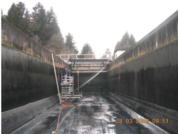
Vorklärbecken Süd im entleerten Zustand
