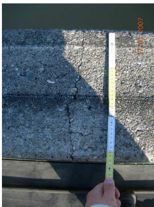
Risse in der Behälterwand
