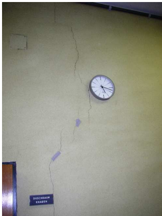
Trennrisse im Kellergeschoß
