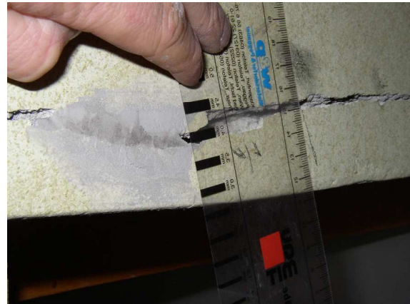
Feststellung der Rissweiten
