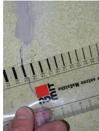
Risse im Erdgeschoss
