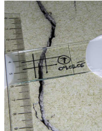
Rissbeobachtung mittels Glasspione
