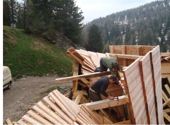
Schadensbild: Aufnahme im Frühjahr
