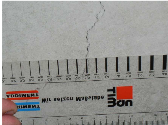
Abb. 02: Biegerisse in der Bodenplatte aufgrund zu geringem Bewehrungsgehalt.
