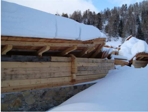
Einsturz zufolge Schneebelastung
