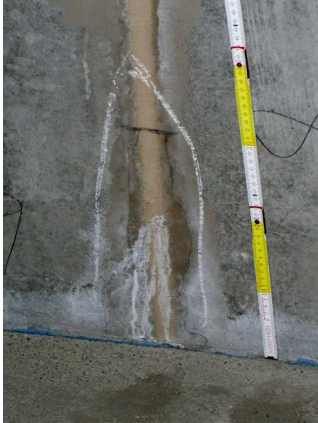
Abb. 01: Wassereintritte in den Baufugen der Kellerwand
